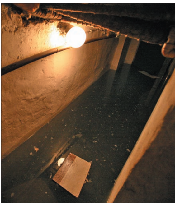
Piwnica jednego z domów w Darkowie. W środku metr wody.
