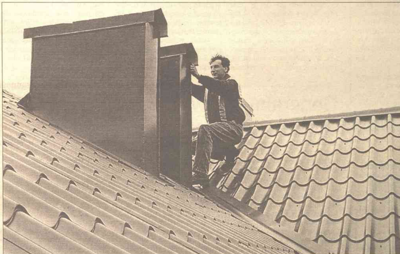
Dzięki pomocy Stowarzyszenia „Wspólnota Polska” kierownictwo szkoły wyremontowało większą połowę dachu. Zanim wykonano ten remont, budynek był w awaryjnym stanie. W czasie deszczu w klasach podstawiano wiadra, tak bowiem lało się z sufitu Fot. Marian Paluszkievicz
