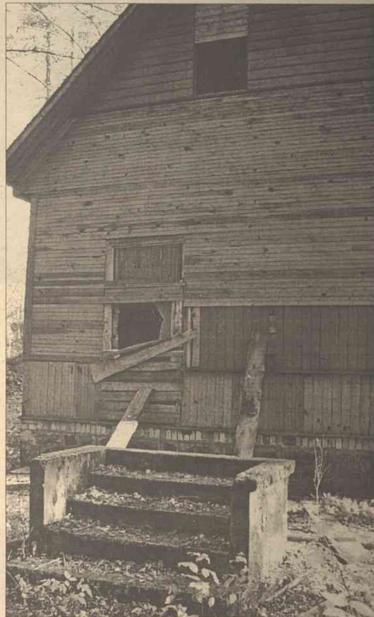
„Złowieszczy” dom na pierwszy rzut oka wygląda raczej żałośnie — powybijane okna, zdemolowany ganek, wylamane drzwi. W środku gołe ściany z poobijanym tynkiem, kilka żelaznych, pokrytych rdzą gratów, w tym szkielet... łóżka. Fot. Marian Paluszkiwicz
