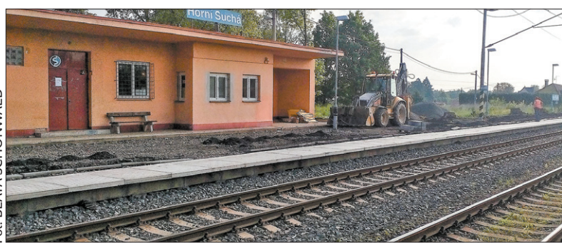
Przed budynkiem dworca kolejowego w Suchej Górnej trwa remont peronu. W związku z przeprowadzanymi robotami, które zakończą się w pierwszych dniach lipca, ruch odbywa się tylko po przeciwnym torze kolejowym. (sch)
