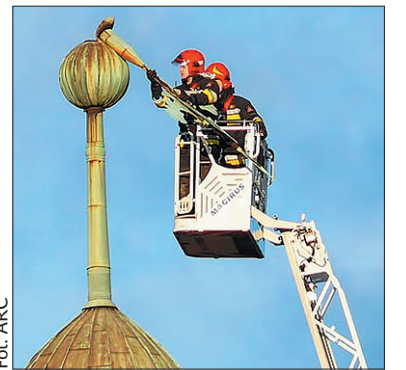
W lutym 2016 r. wichura uszkodziła ratuszową iglicę.
